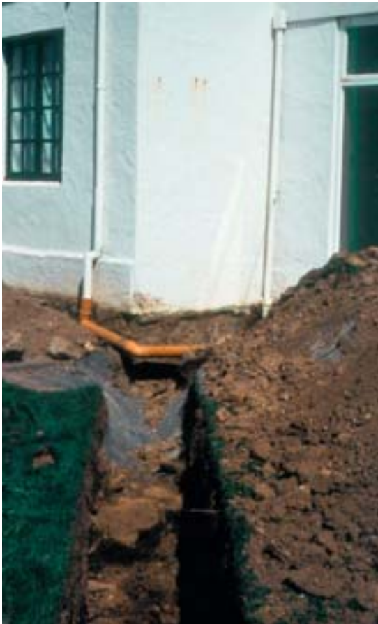
Mynd 58. Afstöðumynd af lagnaskurði (svæði U8) við SV-horn Bessastaðastofu. Skurðurinn er hálfþullur af sandi en undir honum sést glitta í hellugólf sem virðist hafa verið hluti af suðurálmú konungsgarðs (ljósmynd GÓL-1987-04-06).
